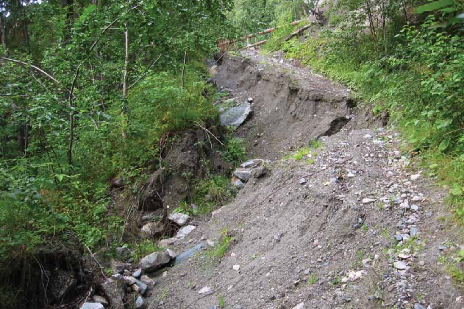
Jordskred utløst etter mye nedbør grunnet anlegging av dårlig drenert skogsbilvei i bratt skråning. Foto: NGI
