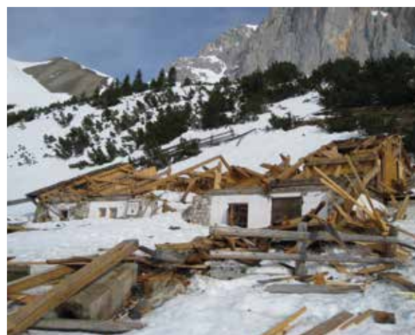
Abb. 7: Beispiele für Lawinenschäden an Gebäuden.
